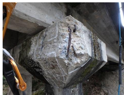
下部構造（剝離・鉄筋露出）
