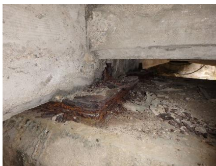
支承（腐食、支承の機能障害）
