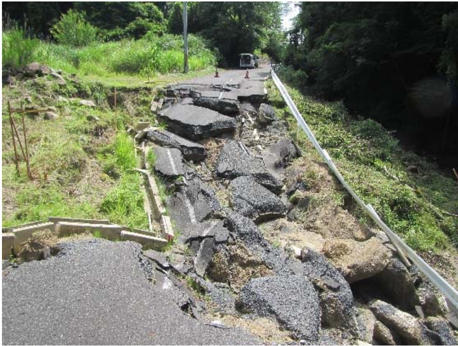
平成 29 年 10 月 21 日台風 21 号 村道アジサイ ロード線での土砂崩れによる道路寸断
